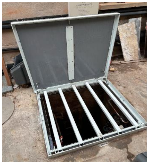
PR Beach : Trappe avec barre anti chute
