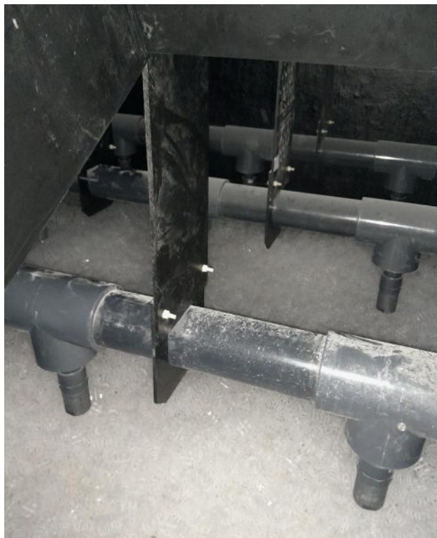
Détail garnissage et rampes aspersions tours
