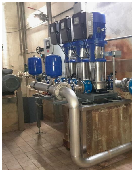
Nouveau Skid Eau Industrielle
