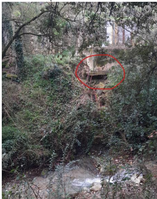
PR Cabrolles: phénomène d'érosion sous la dalle
