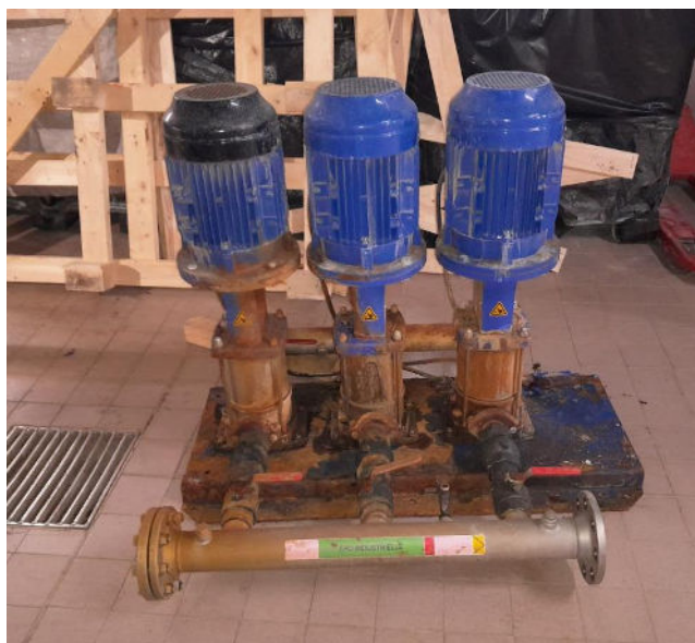
Ancien Skid Eau industrielle
