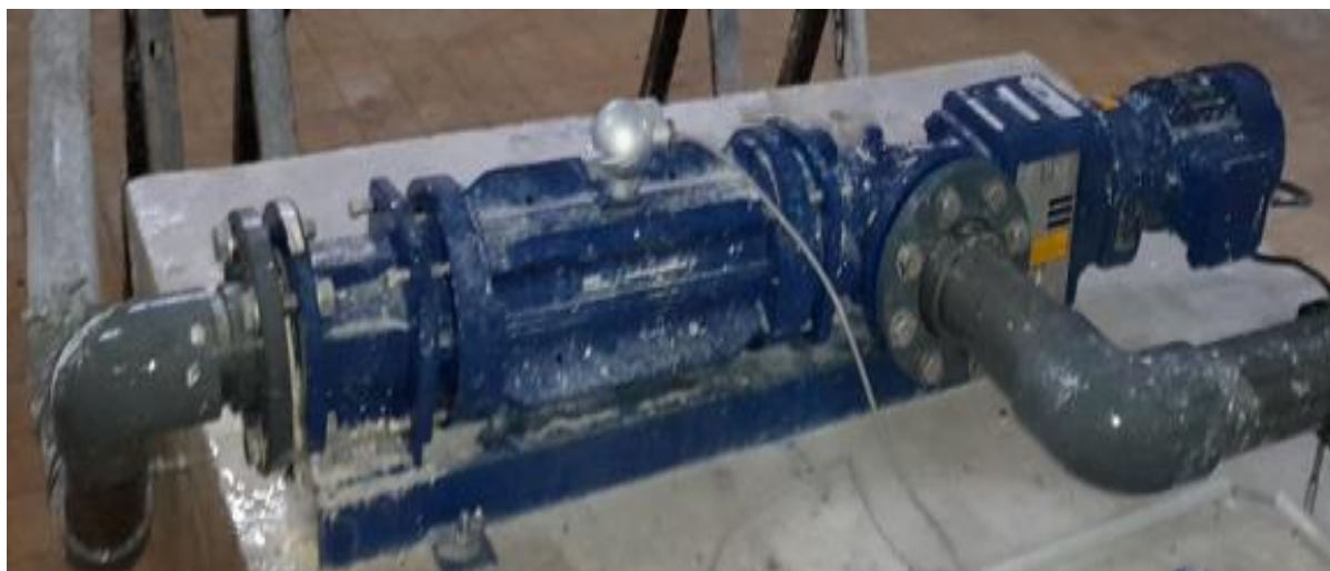
La pompe lait de chaux
