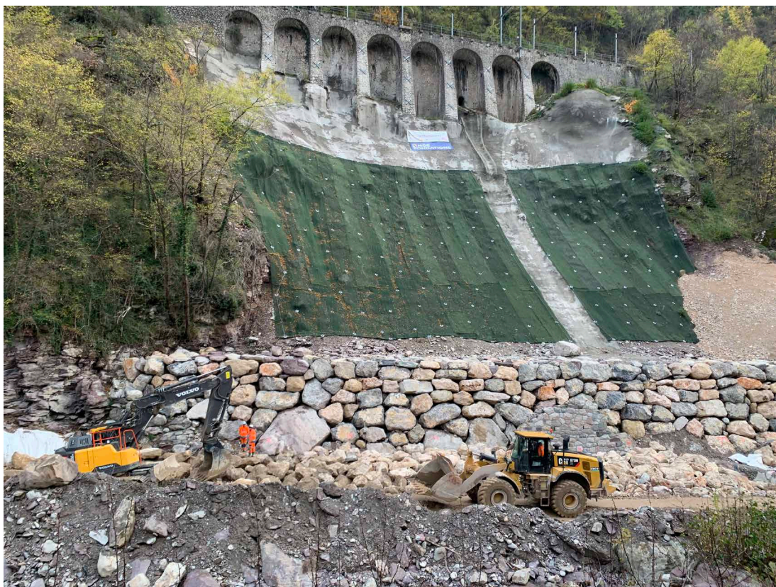
Travaux d'enrochements complémentaires sur la butée au pied du mur à arcatures
